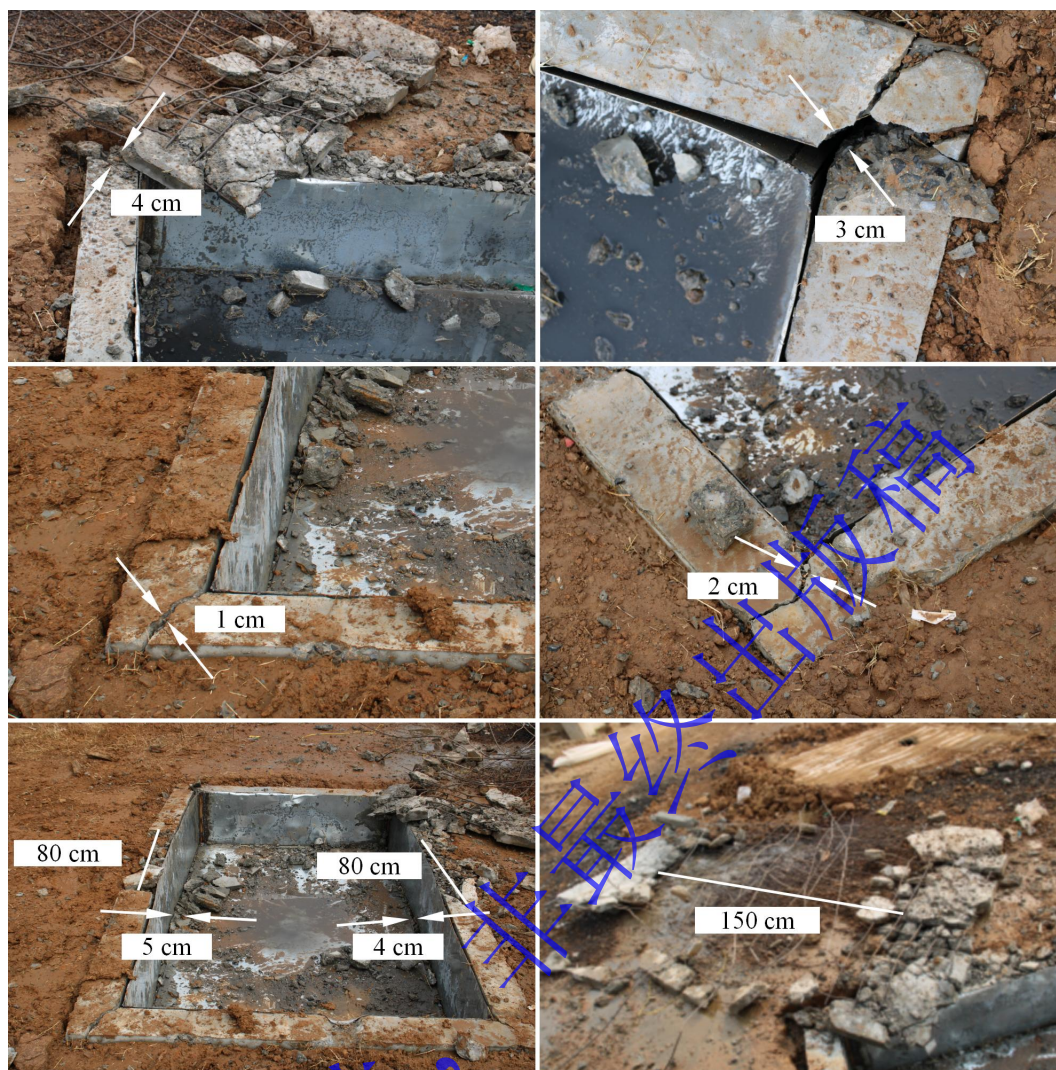
图 12 5#试验油库模型破坏情况
